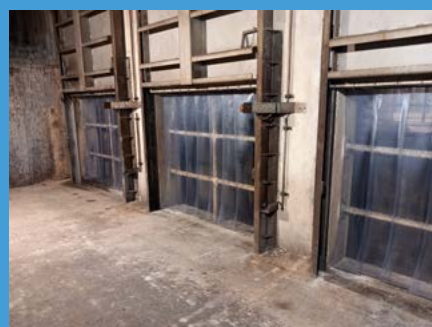
↑ Au niveau des vannes, des bavettes souples ont été installées entre la vanne et la chute dans le puits pour limiter l'impact du dégazage sur les odeurs en surface.
